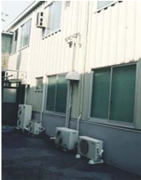
エアコン室外機
